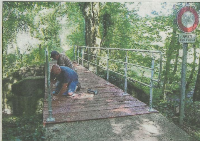
Pascal et Sergilles serrent les derniers boulons des garde-corps sur le pont du Hohlenstein reconstruit.
